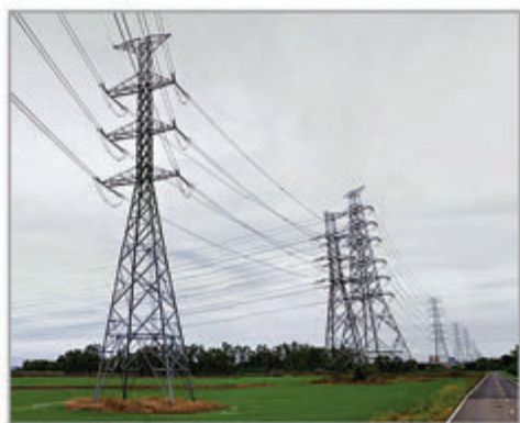
เสาไฟฟ้า
