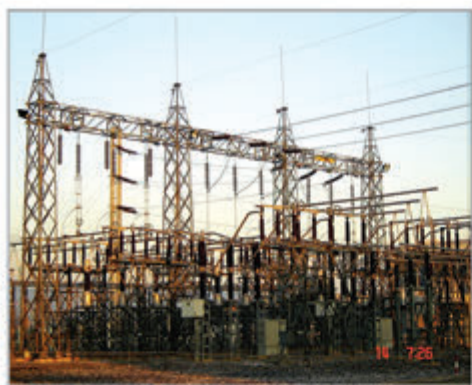
สถานโกไฟฟ้า
